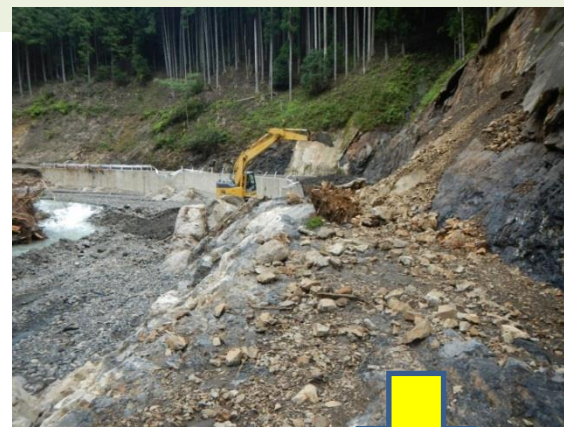
工事用道路 被災 (H26.8)
