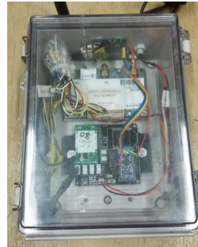
新基板搭載親機 (衛星通信対応型)
