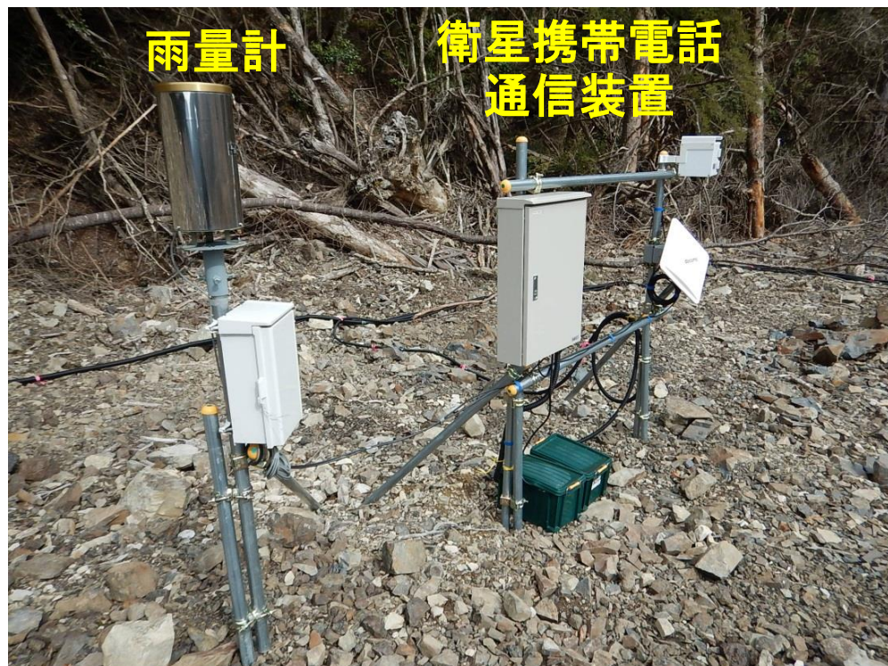
衛星携帯電話を用いた雨量観測所
