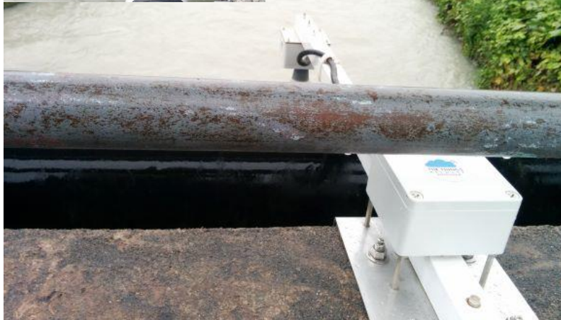
超音波水位計二号機
